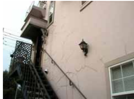
(建物調査対象住宅 壁に亀裂発生状況)
