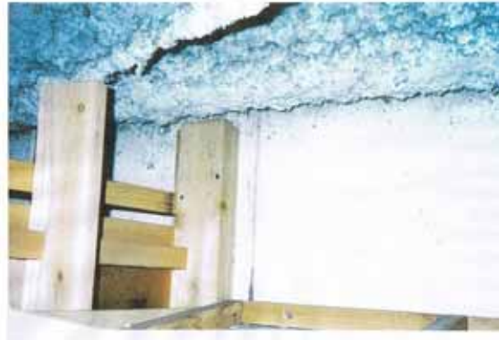
天井裏のアスベスト施工状態
