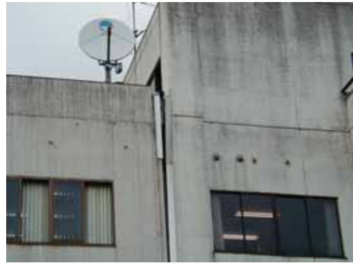
鉄筋造の接合部亀裂
