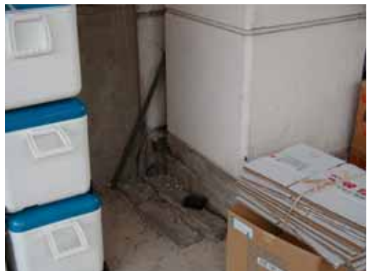
根本から折れた鉄筋基礎
